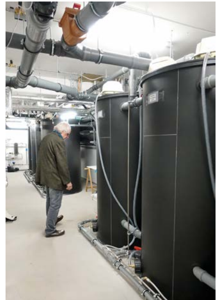
Dreistufiger Grauwasserpuffer im Keller des Apartmenthauses der Berlinovo
