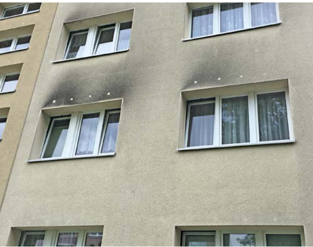
Dämmung ist zwar sinnvoll, muss jedoch richtig ausgeführt werden. Das Fehlerpotenzial ist groß.
