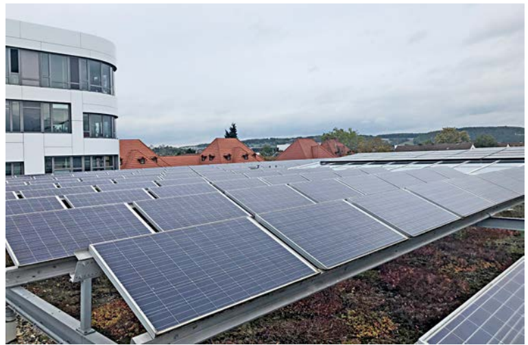
Photovoltaik zur Eigenstromversorgung mag bei Gewerbeimmobilien Sinn machen. Für Mieterstrommodelle braucht es eines geänderten gesetzlichen Rahmens.
