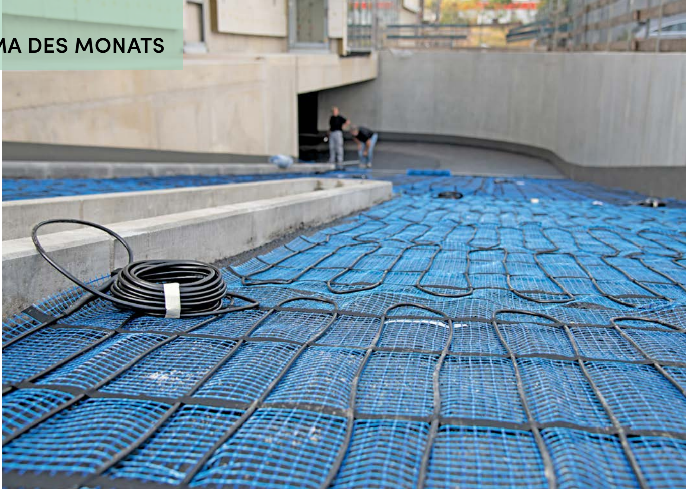
Für eine sichere Ein- und Ausfahrt zur Tiefgarage hat sich die Dogewo21 bei ihrem Neubau für eine elektrische Rampenheizung entschieden. Sie besteht aus einem vorkonfektionierten Mattensystem, einem Feuchte- und Temperaturfühler sowie einem Eismelder
