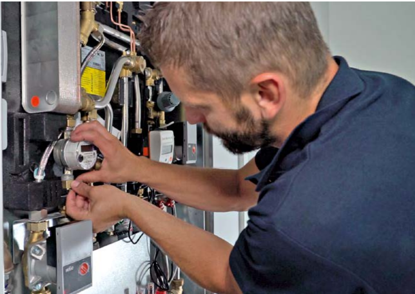
Die Installation funkbasierter Zähler ist eine Grundvoraussetzung für die Selbstabrechnung
