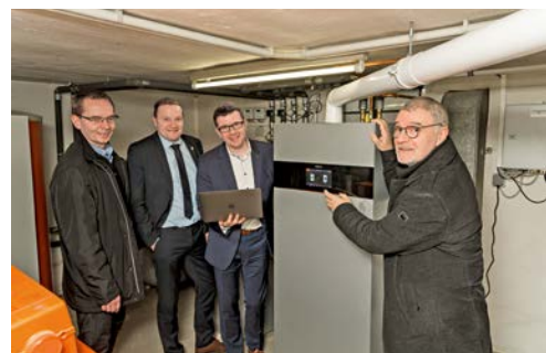
Erstes Resümee des Feldversuchs (v. l. n. r.): Matthias Otto, NHW-Servicecenterleiter Kassel, Jürgen Bluhm, NHW-Regionalcenterleiter Kassel, Alexander Dauensteiner, Bereichsleiter bei Viessmann, und NHW-Haustechniker Jürgen Schaumburg ziehen eine positive Bilanz
