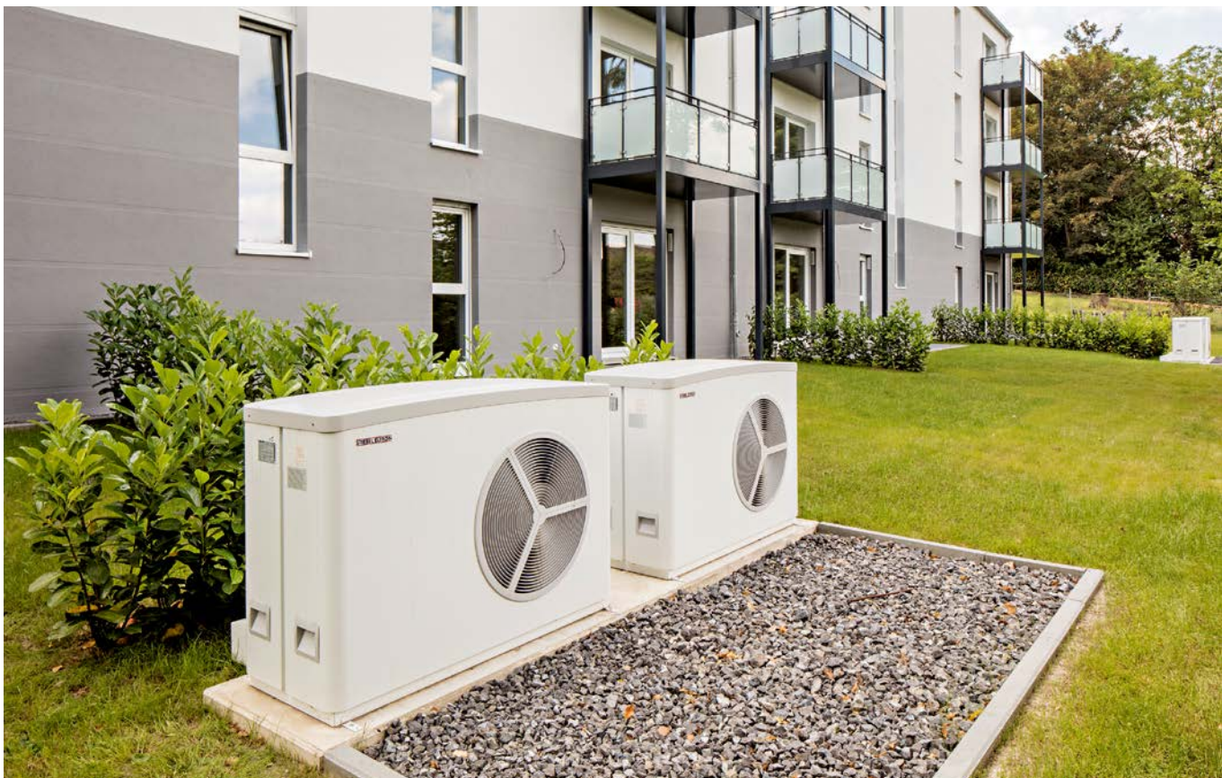
Skalierbare Lösungen mit ganz unterschiedlichen Einsatzvarianten für Bestandsimmobilien gehören heute für die Hersteller von Wärmepumpen-Technologie – hier eine Luft-Wasser-Wärmepumpe der Firma Stiebel Eltron in Würselen – zum Leistungsportfolio
