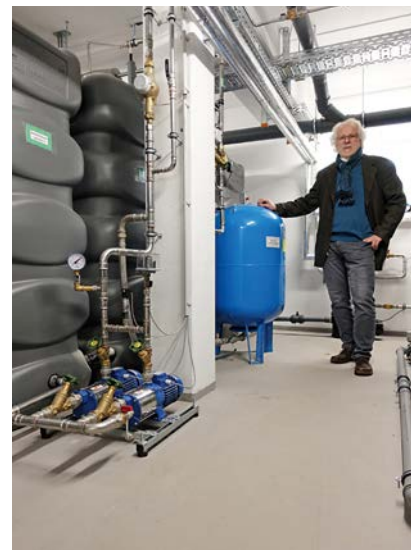
Links der sechsteilige Vorratsspeicher für das Betriebswasser. Vorne die Druckerhöhungsanlage, die nach Bedarf mit fünf bar die Toilettenspülung in den 399 Apartments versorgt. Hinten (blau) der Druckausgleichsbehälter. Er sorgt dafür, dass nicht bei jeder einzelnen Spülung die Pumpen anspringen
