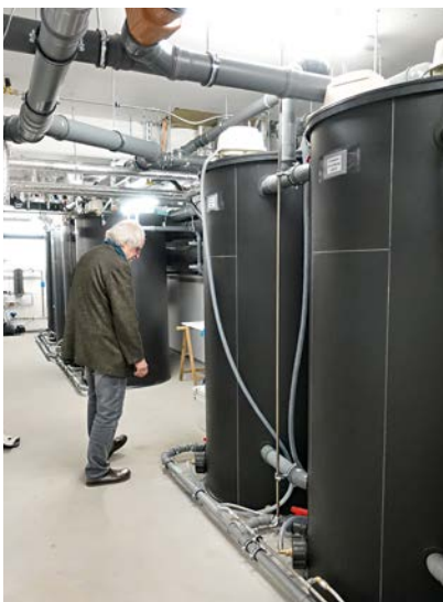
Dreistufiger Grauwasserpuffer im Keller des Apartmenthauses der Berlinovo
