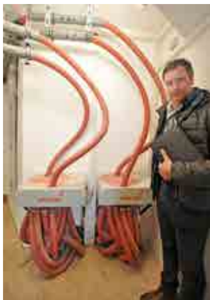
Die Förderung der Pellets erfolgt vom separat liegenden Lager über ein SONDENSAUGSYSTEM bis zu den Pelletskesseln
