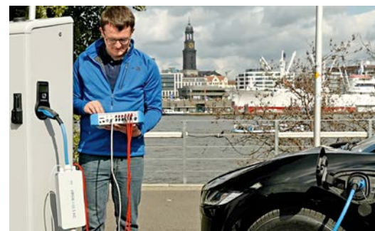
Neben der Installation wird auch der Betrieb der Ladesäulen, wie hier die Eichung, Kosten für den Betreiber verursachen
