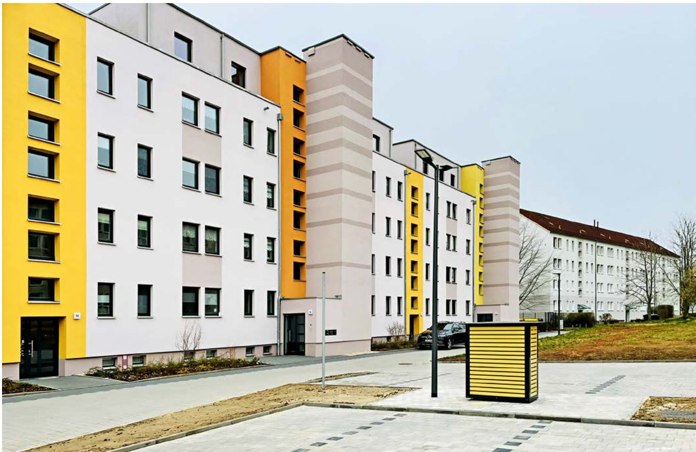
Eine Ladesäule für E-Autos mit einer Leistung von 11 kW vor einem frisch sanierten Wohnblock
