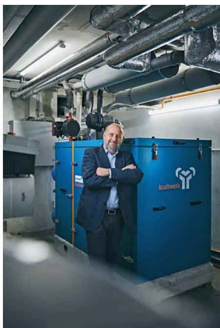
ENVI-Geschäftsführer Dr. Winfried Ponischowski vor einer Heizungsanlage
