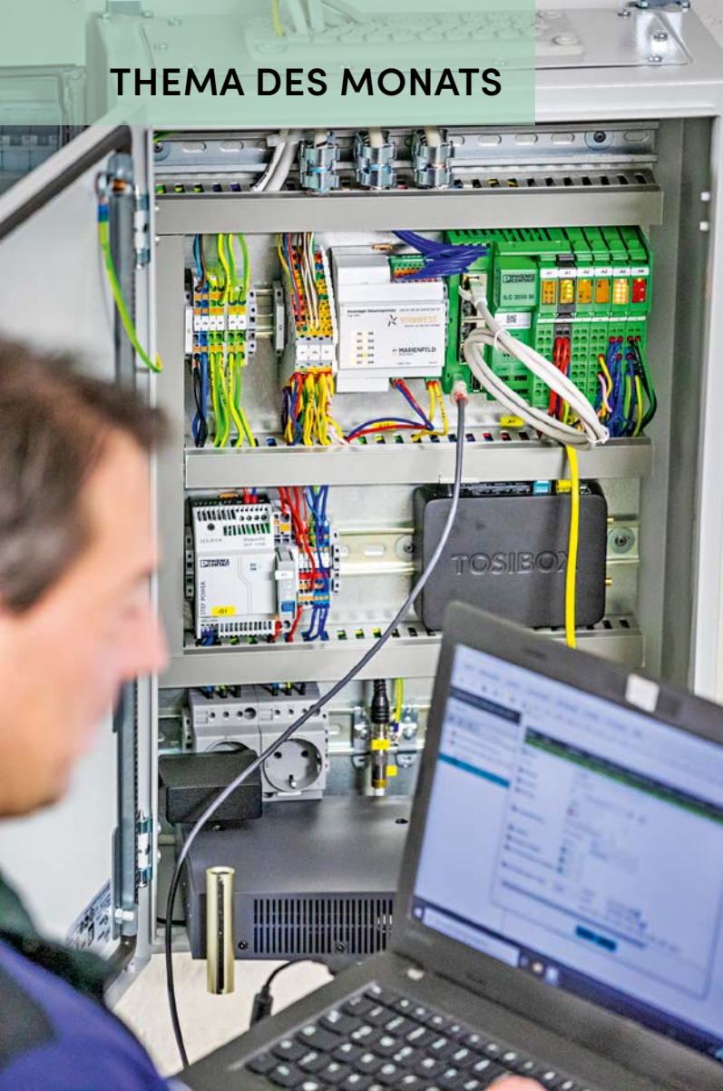
Die Herzstücke des digitalen Gebäudemanagements sind der Gebäudecontroller (grüne Box im Verteilerkasten) und die Gebäudemanagementplattform
