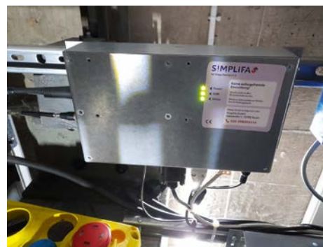
So sieht die IoT-basierte Box des Aufzugsdienstleisters Simplifa aus
