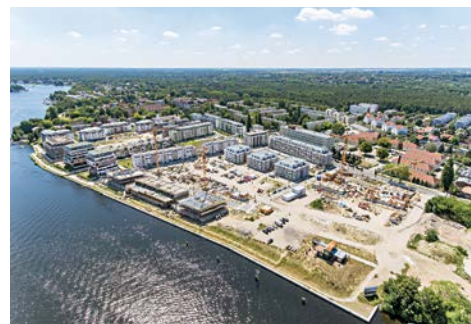
Das Projektgebiet aus der Luft im Mai 2019. Mittlerweile sind die Bauarbeiten bereits deutlich vorangeschritten
