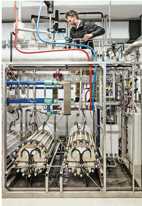
Mit einer Leistung von 1 MW sind die Elektrolyseure kein riesiger Beitrag zur Energiewende, aber eine wichtige Wegmarke. Folgeprojekte mit deutlich höherer Kapazität sind geplant
