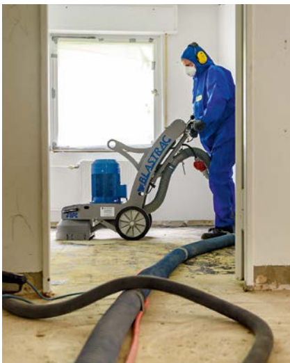
Von der Schleifmaschine über den 60 m langen Saugschlauch gelangt der asbesthaltige Schleifstaub ohne Kontakt mit der Umwelt in den Abscheider außerhalb des Gebäudes
