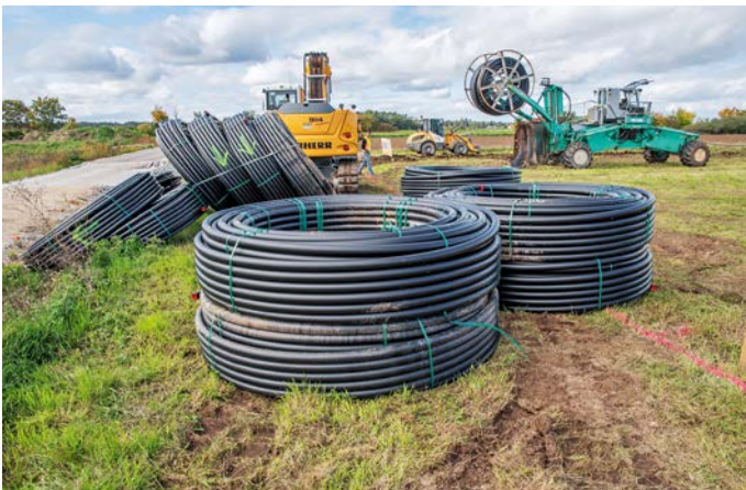
Insgesamt 16 km Rohrleitungen werden in 2 m Tiefe durch den Leitungspflug (hinten rechts im Bild) eingepflügt.
