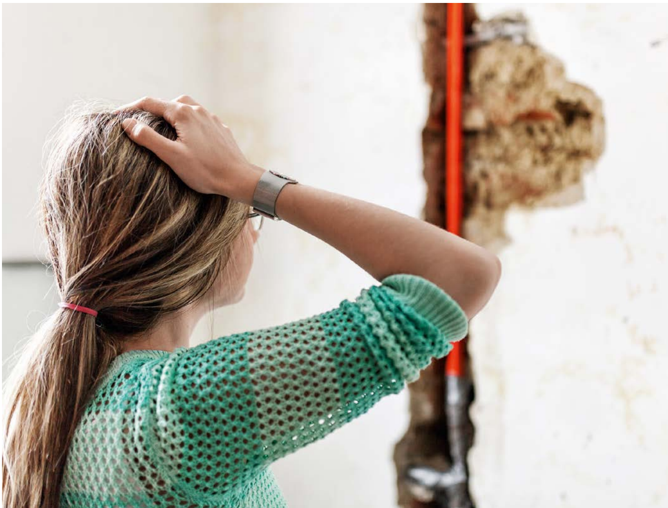
Wasserschäden sind der häufigste Fall, bei dem die Gebäudeversicherung einspringen muss
