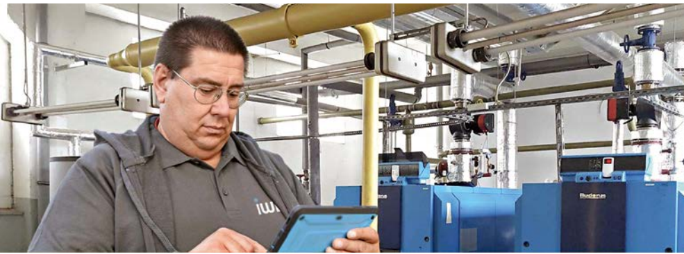
Immer mehr Wohnungsunternehmen führen ein laufendes Monitoring der Heizungsanlagen durch, um die Anlageneffizienz zu erhöhen und den Energieverbrauch zu reduzieren
