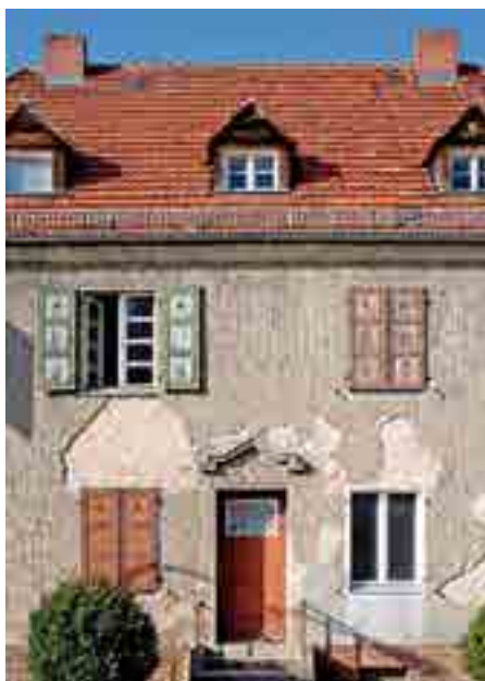
Ein Beispiel vom Zustand der Häuser vor der Sanierung
