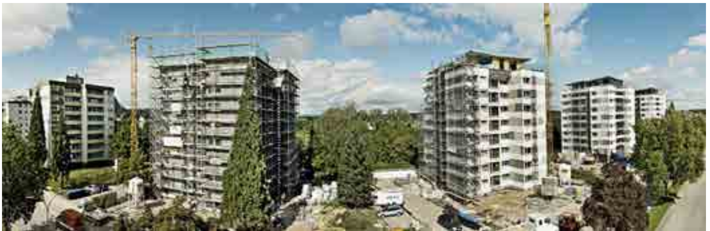
Für die Genossenschaft war die umfassende Modernisierung der fünf Häuser und 200 Wohnungen eine Mammutaufgabe
