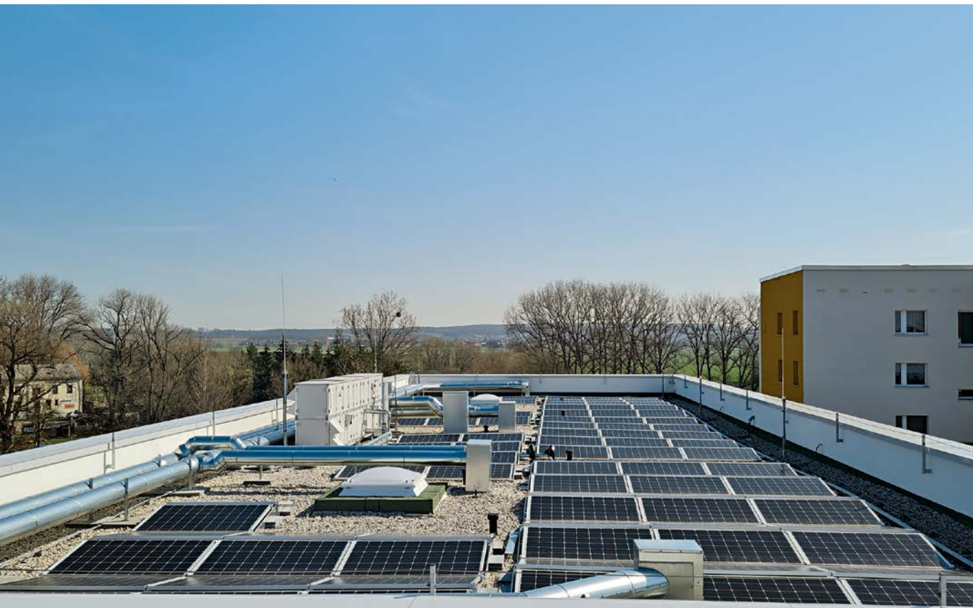
Der auf dem Dach erzeugte Strom wird als Mieterstrom vermarktet. Alle 20 Mieterhaushalte beziehen diesen Strom
