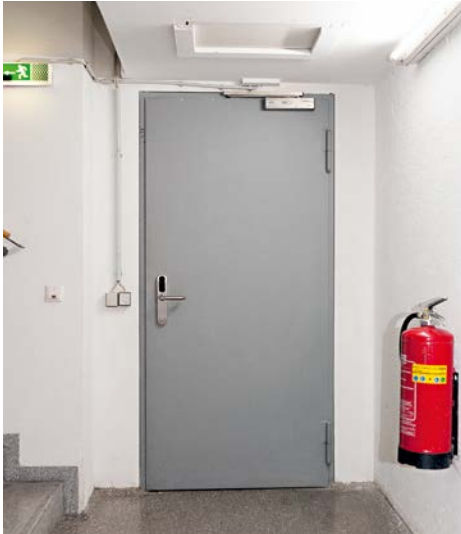
Handwerkern kann beispielsweise gezielt Zugang nur zu bestimmten Räumen erteilt werden – per Transponder oder Smartphone-App
