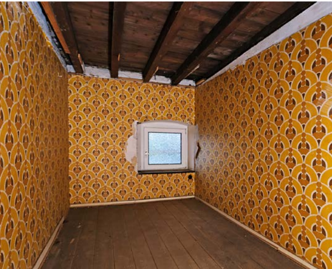
Vor Jahren noch als Wohnraum genutzt, dienen die Dachzimmer nun als Abstellräume und Kellerersatz
