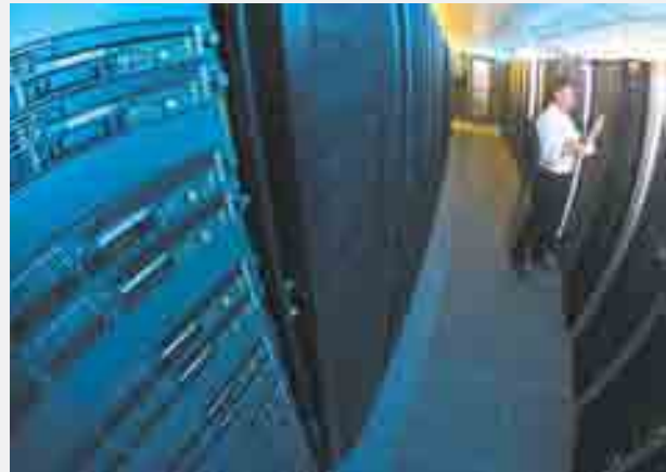
Server im DATEV-Rechenzentrum: Die Anwendungen können auch im Application Service Providing in Nürnberg betrieben werden.
