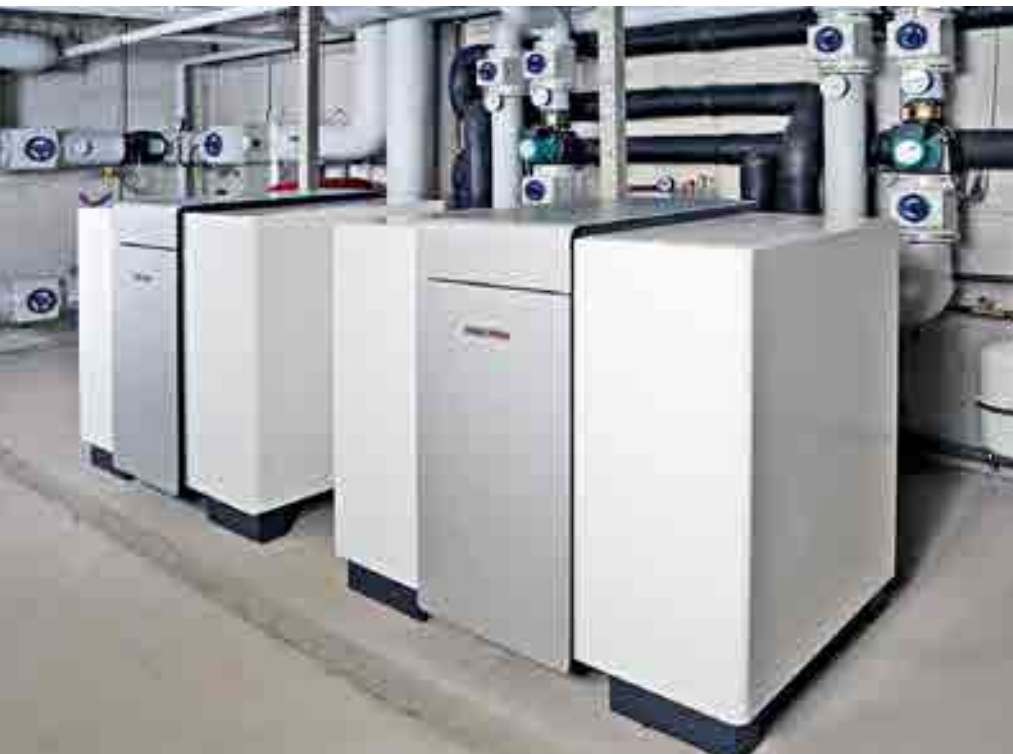
Eine Sole-Wasser-Großwärmepumpe arbeitet besonders lärmarm.
