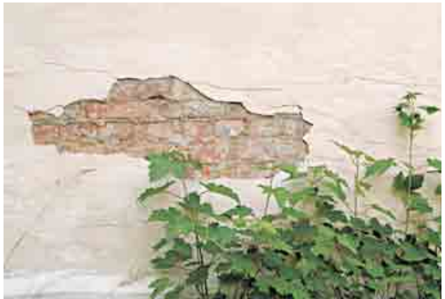
Der Sanierungsbedarf ist bei vielen Häusern von WEGs groß.
