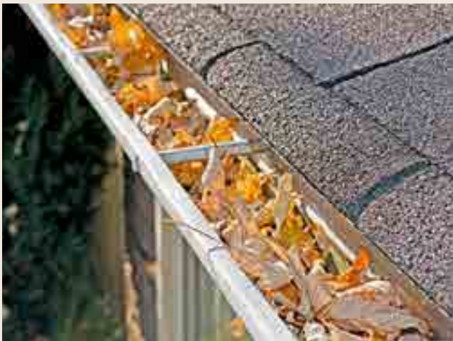
Dachrinne. Vermieter hat keine regelmäßige Kontrollpflicht.
