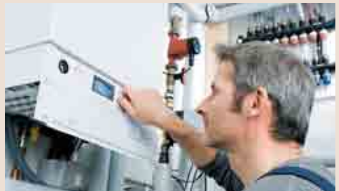
Gaszentralheizung. In der Regel Energieeinsparmaßnahme.
