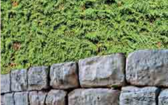
Einfriedung. Bauliche Veränderung.
