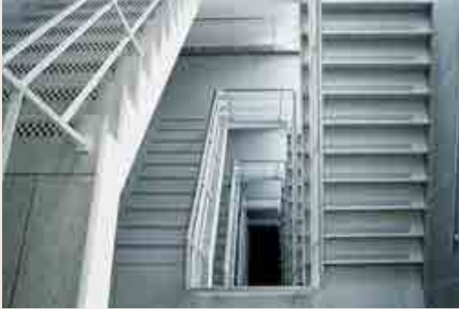
Zigarettenrauch im Treppenhaus ist zu vermeiden.
