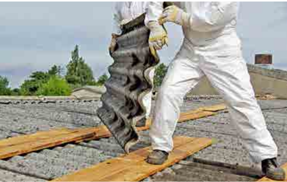
Die Sanierung von Asbest kann als außergewöhnliche Belastung gelten.
