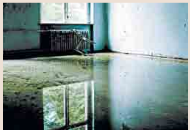
Ein drohender Wasserschaden berechtigt zur Notgeschäftsführung.
