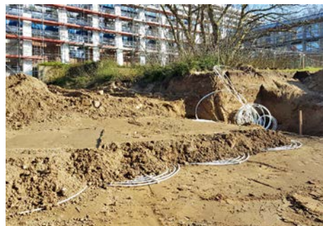
Die Eckernförder GWU versorgt bei ihrem Projekt Noorblick 91 Neubauwohnungen mit einem Erdkollektor mit 250 kW Entzugsleistung
