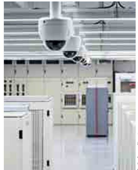
Eine lückenlose Außenhaut- und Innenraumüberwachung mit 360°-Dome-Kameras schützt die im Rechenzentrum liegenden IT-Systeme
