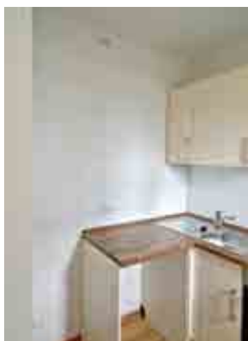
Unauffällig integriert: der Ablufteinlass unter der Decke der Küche
