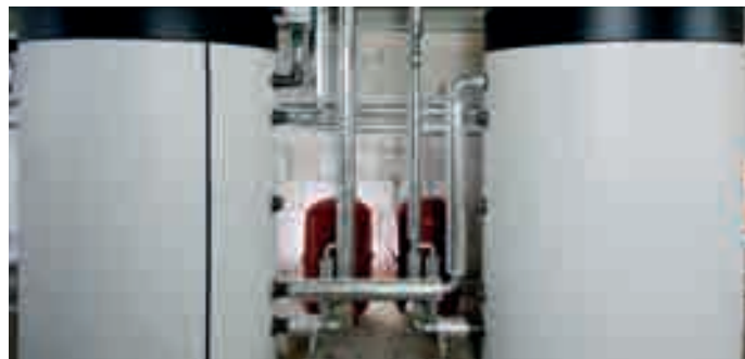
Die Pufferspeicher werden von der Wärmepumpe und der Solaranlage beladen und liefern die Energie zur Trinkwassererwärmung für die Wohnungsstationen.
