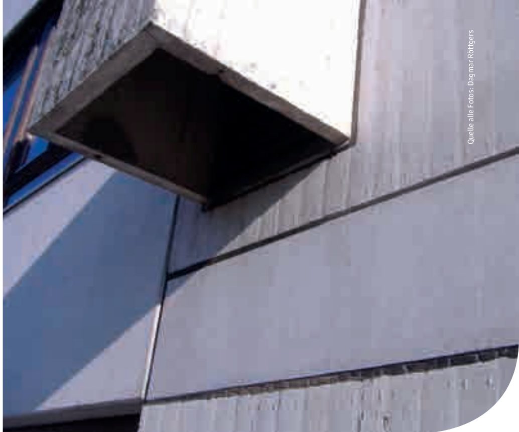
Gebäude-Außenfassade mit PCB-haltigen Fugenmassen
