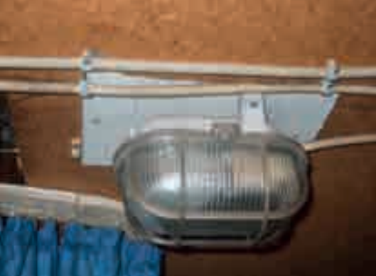
Lampe auf schwach gebundener Asbestplatte
