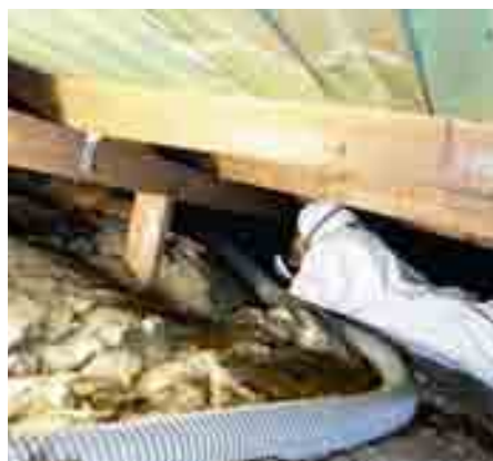
Um die Entwässerungsabflüsse des Flachdaches betrug die Arbeitshöhe im Belüftungszwischenraum nur noch wenige Zentimeter.
