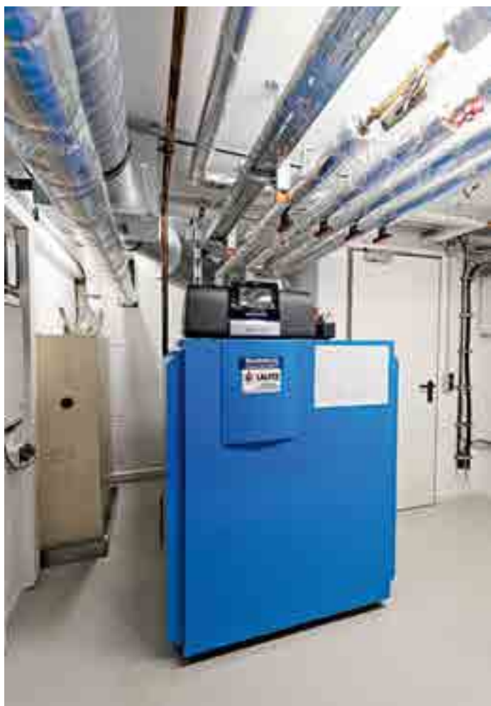
Mit 160 kW Leistung deckt der Gasbrennwertkessel die Spitzenlast
