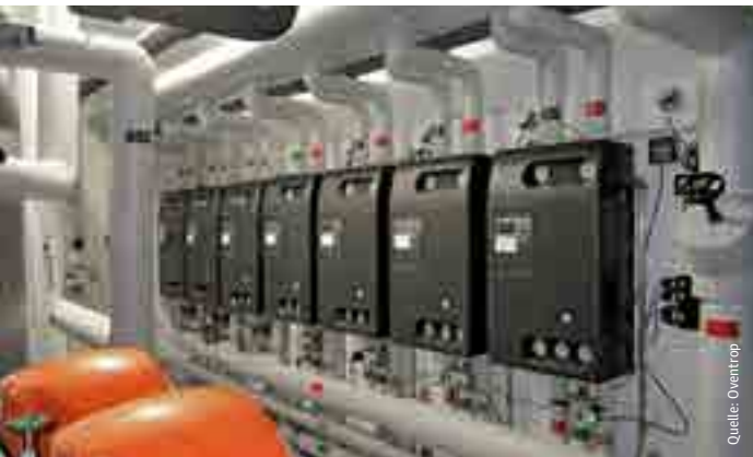
Hygienisch einwandfrei und energieeffizient: dezentrale Wohnungsstationen
