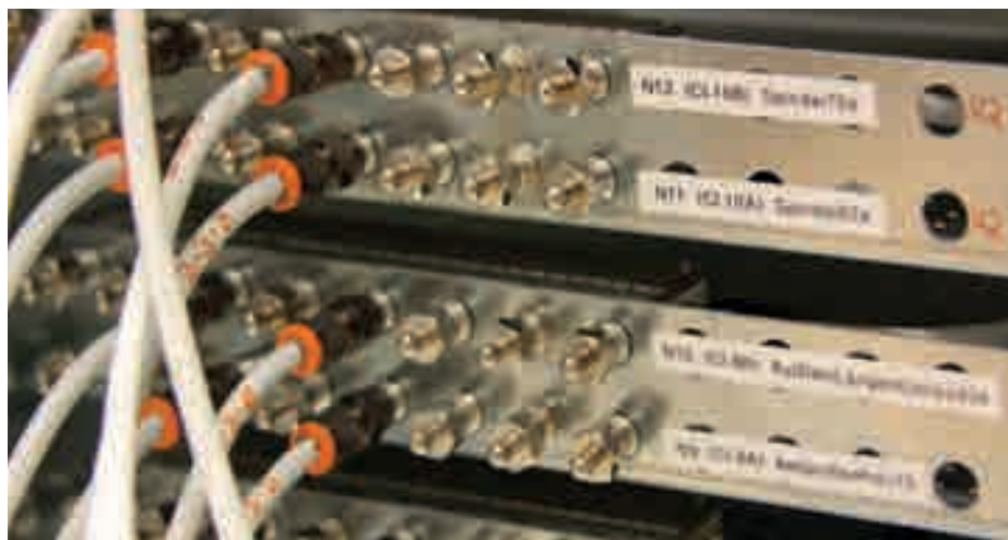
Keine Unabhängigkeit ohne die erforderliche Technik: die Kopfstation im Verwaltungsgebäude der Freien Scholle
