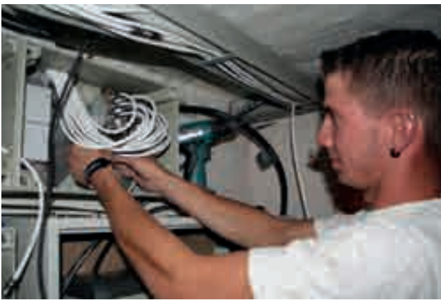
Kompetenz vor Ort: Dank der guten Zusammenarbeit der Kooperationspartner läuft der Netzbetrieb reibungslos
