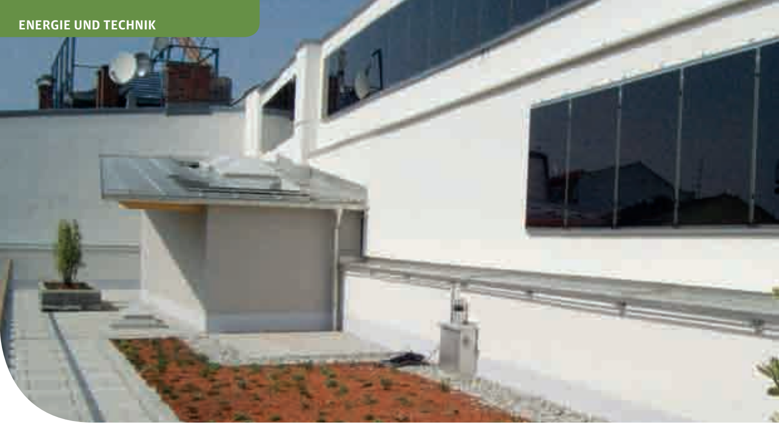
Dachterrasse mit einer PV-Anlage
