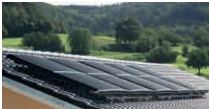
Spezielle Solar-Luftabsorber sammeln die Wärme aus der Luft und der solaren Einstrahlung. Bevorratet wird sie im Eisspeicher.
