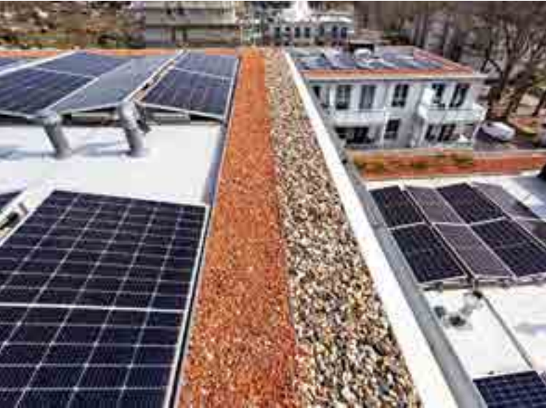
Die Nutzung regenerativ erzeugter Energie ist heute unverzichtbar: PV-Anlage auf den Dächern des ersten Bauabschnitts im März 2022
