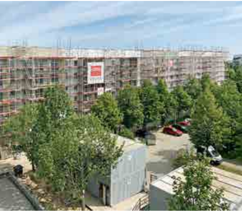
Die Sanierung der fünf Mehrfamilienhäuser erfolgte zeitlich versetzt, um Corona-bedingte Verzögerungen auszugleichen
