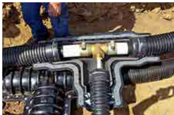
Detail eines kalten Wärmenetzes in Haßfurt mit dem Anschluss zu einem Abnehmer. Eine Isolierung ist nicht nötig, die Verlegung ist unkompliziert und erfolgte mit der Neuverlegung der Wasserleitungen
