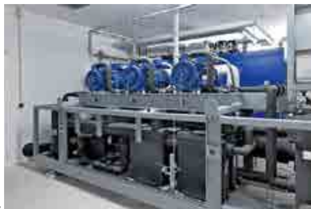
Wärmepumpe des Netzes in Dollnstein
