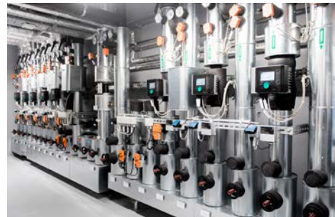
In vielen Beständen fehlen strukturierte, durchgängig verfügbare Betriebsdaten. Oft ist der Zugriff darauf mit erheblichem Aufwand verbunden
