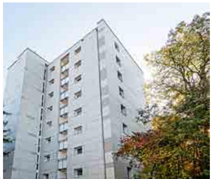
Die Fassadensanierung mit VHF trägt zur deutlichen Verbesserung des Wohnkomforts sowie des Wärme- und Schallschutzes bei
