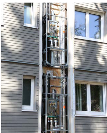
Außen liegende Technikstränge ermöglichen eine minimalinvasive TGA-Erneuerung mit Wartungsmöglichkeit ohne Wohnungszutritt
