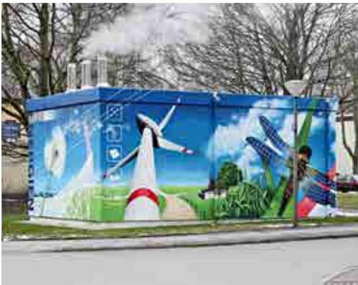
Umweltfreundlich und farbenfroh: Seit Herbst 2012 versorgt ein Blockheizkraftwerk in Dortmund-Schüren über 300 Wohnungen deutlich effizienter mit Wärme
