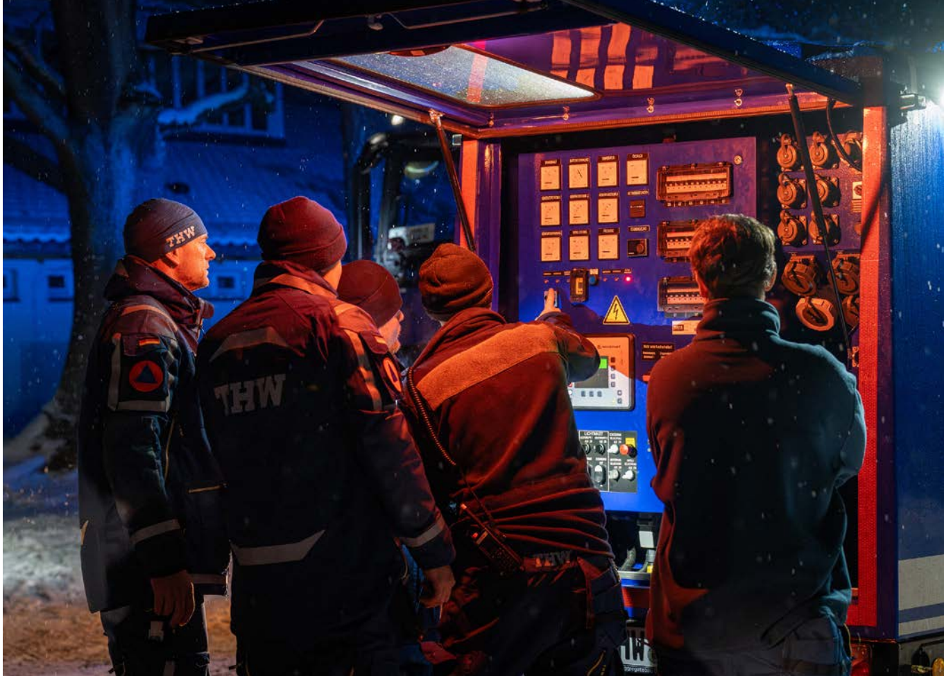
Beim großflächigen Stromausfall im Südwesten Berlins Anfang Januar 2026 unterstützte das Technische Hilfswerk bei der Notstromversorgung
