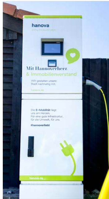
Die Ladesäulen von Hanova stehen allen Anwohnern im Quartier zur Verfügung
