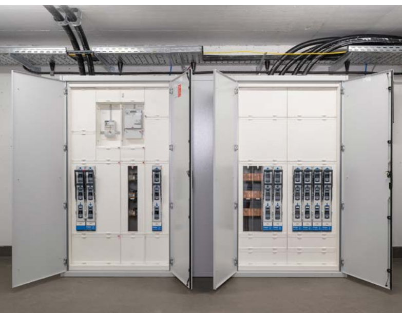
Ausbaufähige Energieverteilung, wie hier von der Firma Hager in einer Tiefgarage ausgeführt, ist Grundvoraussetzung für skalierbare Lösungen
