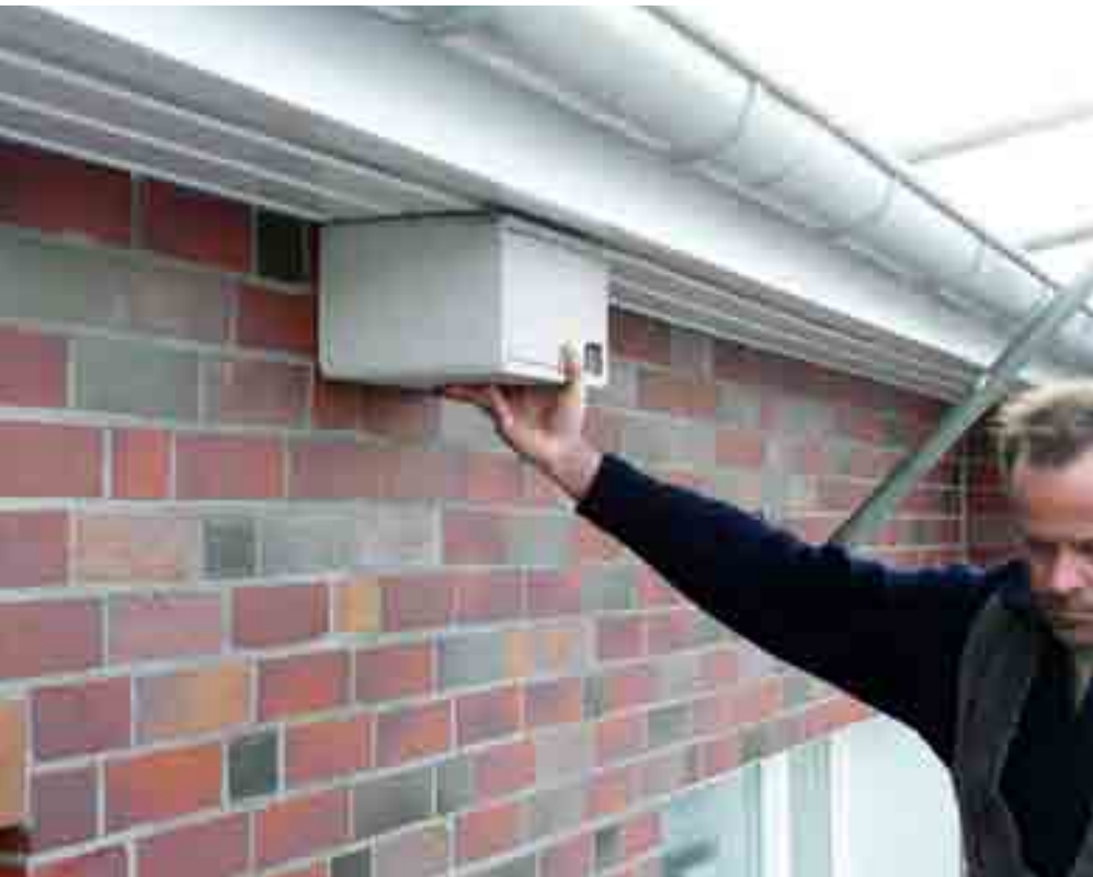
Unter der Dachrinne bringt ein Handwerker ein neues Vogelquartier an. Quelle: ASK Hassenstein + Pfadt GmbH
