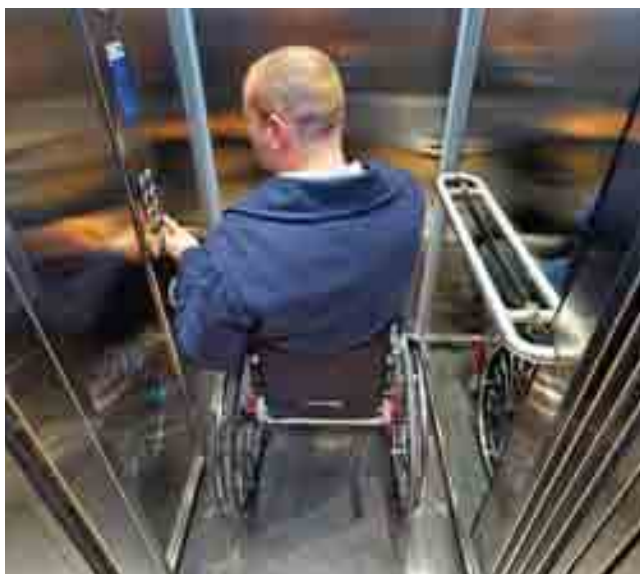
Sicher und bequem ist der neue Aufzug der Ochsenzoller Straße 148 gerade für Rollstuhlfahrer.
