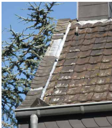
Gefährdung am Dachrand
