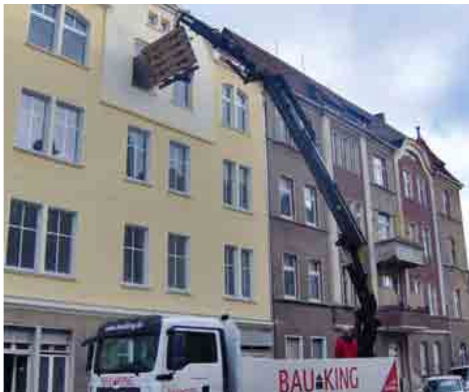
Moderne Hochkranfahrzeuge können Baustoffe präzise und behutsam in bis zu 30 Metern Höhe absetzen.
