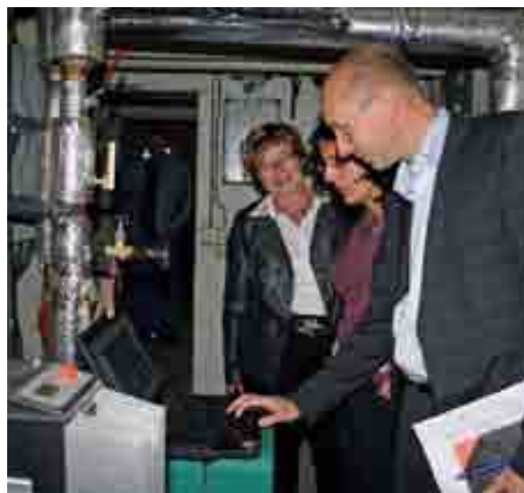
WG-Vorstand Jens Schneider (vorn) lässt sich am Laptop die Leittechnik-Software für die modernen Heizanlage erklären.
