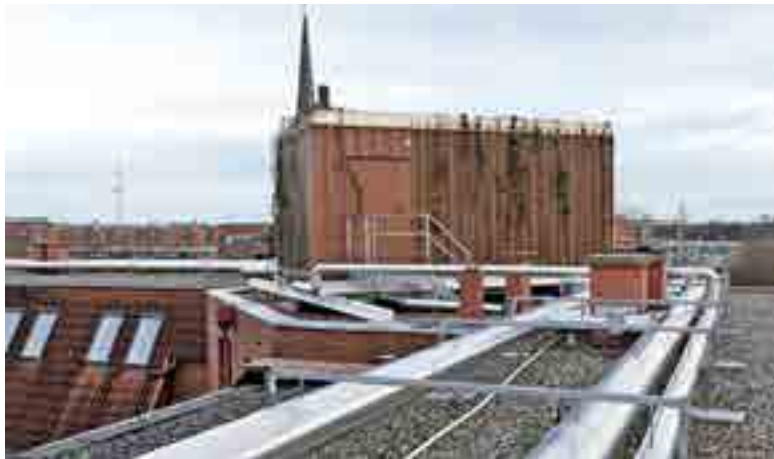
Da es dem Gebäude aufgrund des feuchten Untergrundes an einem Keller mangelt und auch ein Dachgeschoss fehlt, findet sich die Primärversorgung nach der Sanierung in zwei Seecontainern auf dem Flachdach des Hauses
