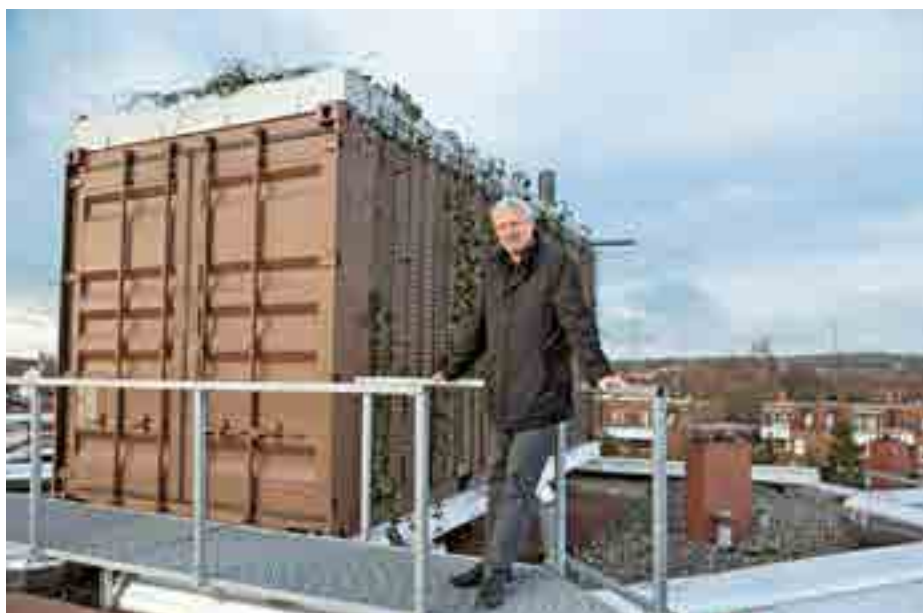
Fachplaner Claus Schellhorn hatte die Idee, die zentrale Wärmeversorgung des Wohnhauses in zwei Seecontainer auf das Dach zu verlegen
