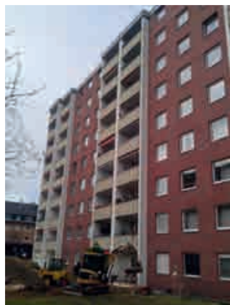
Vor der Sanierung: Das Mehrfamilienhaus in Köln Zollstock entsprach nicht den heutigen energetischen und ästhetischen Anforderungen
