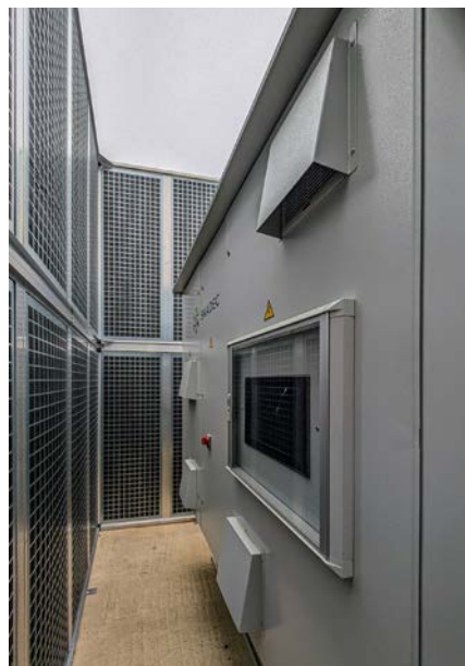
Zwischen Innenwand der Schallschutzhülle und Wärmepumpe liegt ein gut zugänglicher Wartungsweg
