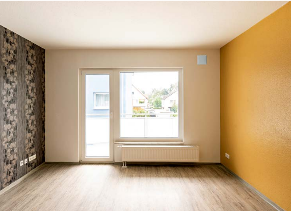
In jeder Wohnung kommen zwei Lüftungsgeräte LWE 40 zum Einsatz. Sie arbeiten im Pendellüftungsprinzip, sodass in der Wohnung kein Unterdruck entsteht
