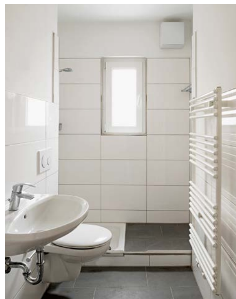
In den Bädern kommen dezentrale Abluftgeräte LA 60 zum Einsatz
