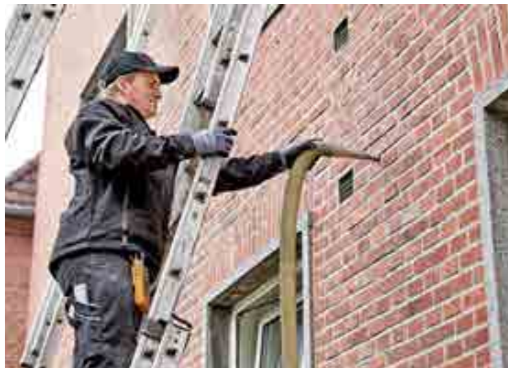
Rund 90 m 3 Granulat wurden in weniger als einer Woche in die Außenwände von drei Mehrfamilienhäusern in Emden eingebracht
