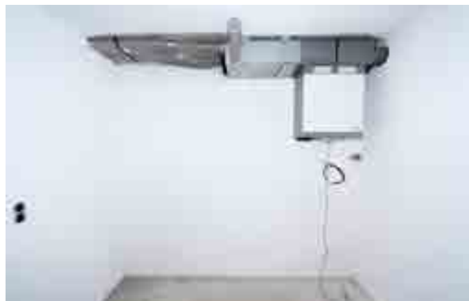
Das zentrale Komfortlüftungsgerät (rechts) findet in den meisten Küchenschränken oder in Badezimmerischen Platz
