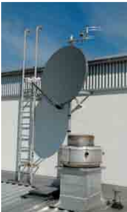
Ein einzelner Satellitenspiegel auf dem Dach reicht aus, um alle Wohneinheiten (wie hier in der Richard-Schirrmann-Straße in Mainz) kostengünstig mit Fernsehen zu versorgen.
