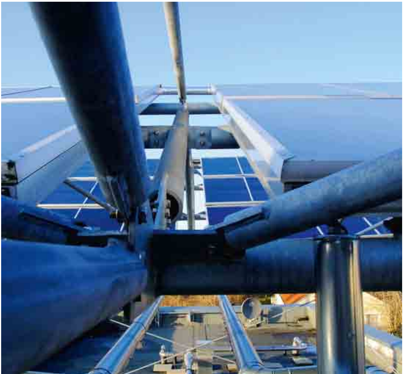
Blick auf die Solarthermie-Anlage
