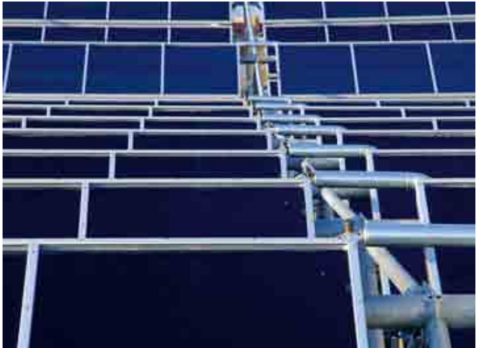
Große Solarthermie-Flächen sorgen in den Mehrfamilienhäusern in der Magdeburger Straße in Hannover seit vielen Jahren für warmes Wasser. Foto: Jörg Axel Fischer
