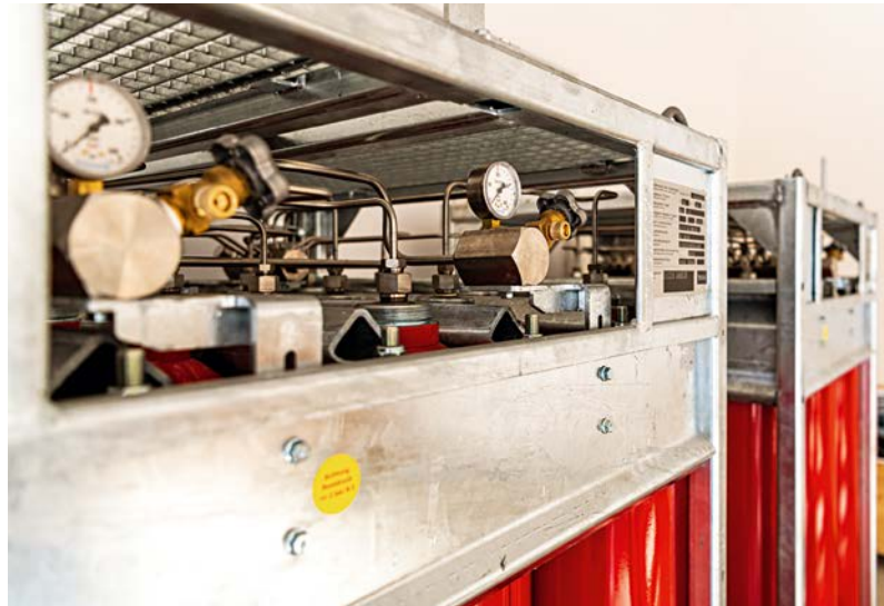
Der Wasserstoff wird in großen Gasflaschen bei einem Druck von 30 bar gespeichert. Zuvor hat ein Elektrolyseur mit Photovoltaikstrom aufbereitetes Leitungswasser in Wasserstoff und Sauerstoff gespalten
