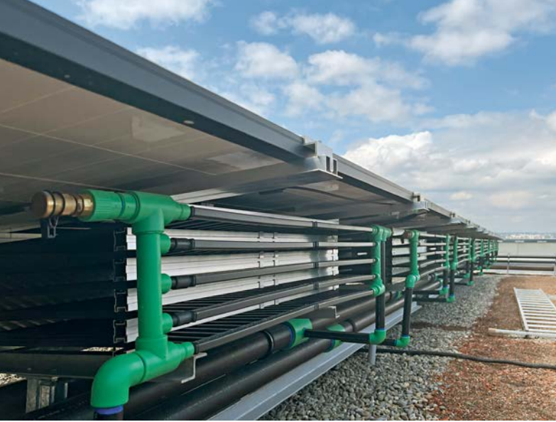
Die mehrlagigen Rohrregister unter den Solar-Hybridkollektoren auf den Dächern des Neubaus am Prießnitzweg
