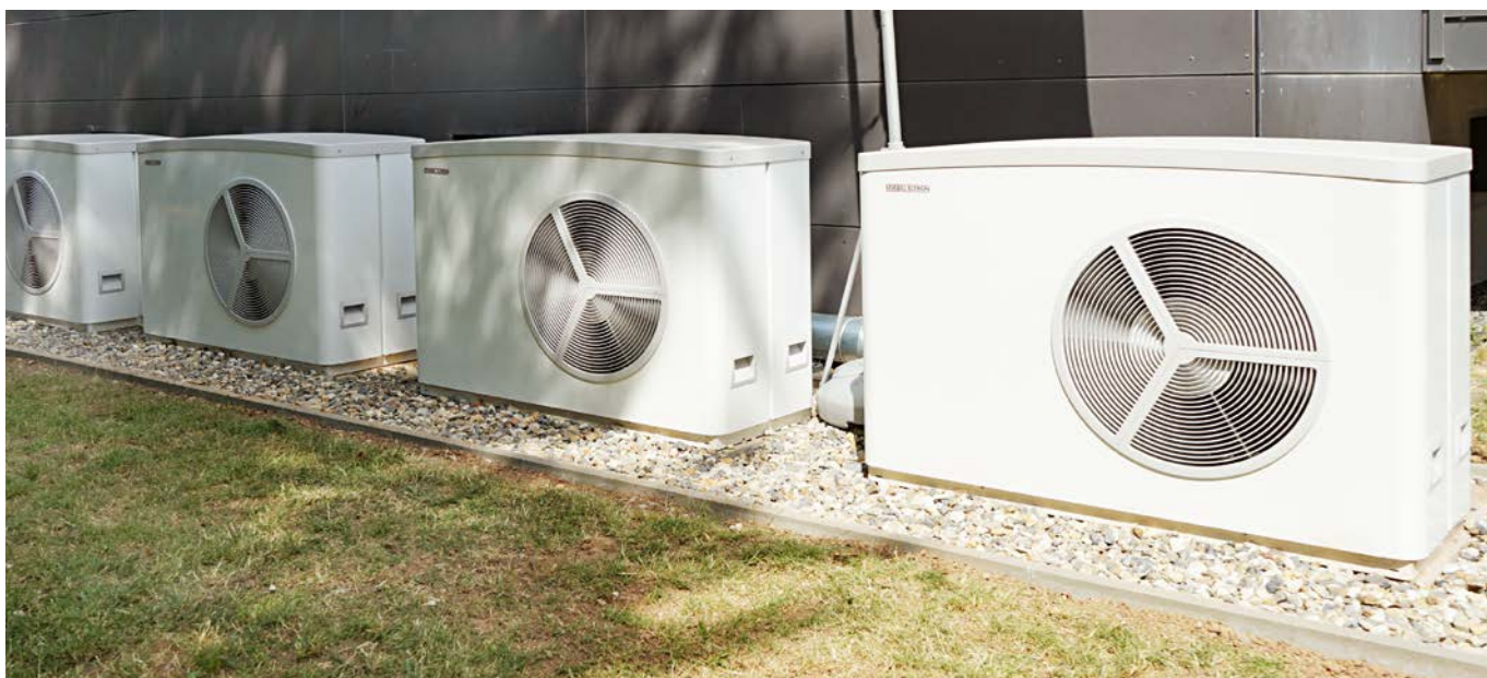
Das achtgeschossige Gebäude wurde mit vier in Kaskade geschalteten Luft-Wasser-Wärmepumpen ausgestattet
