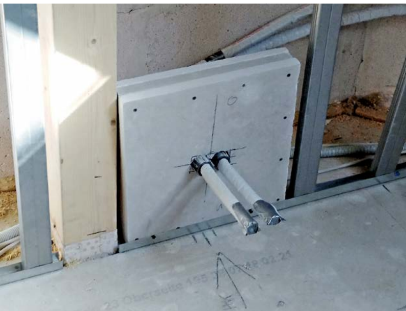
Klassische Ausbausituation im Dachraum: brandschutzgerechte Vorbereitung in der Decke zur Strangdurchführung (oben) und brandgeschützte Durchführung von Heizungsleitungen (unten)
