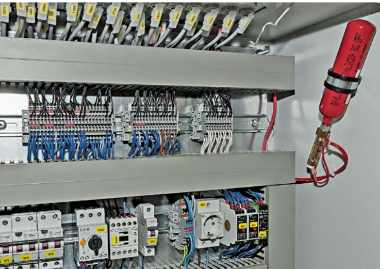
Ein AMFE, ein Mini-Feuerlöscher, ist rechts an der Wand eines Verteilerkastens montiert
