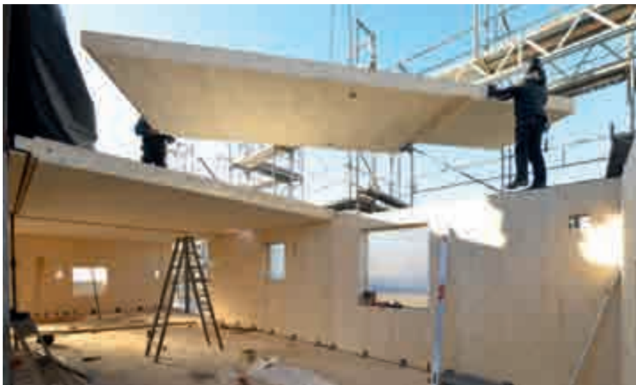
Bedingt durch den hohen Vorfertigungsgrad der massiven Wand- und Deckenelemente konnte der hölzerne Rohbau in Kurzeit errichtet werden
