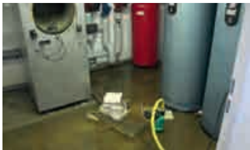
Auch die Heizzentrale in der Wagnerstraße 14 war von der Flut betroffen
