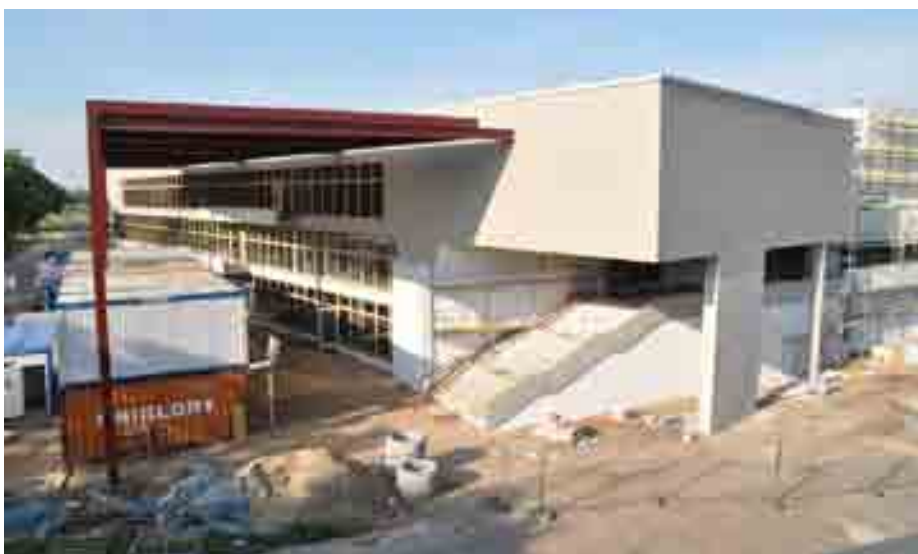
Im Rahmen des Projekts „Schulen in Hamburgs Süden“ steht das Bildungs- und Gemeindezentrum (BGZ) in Neugraben-Fischbek kurz vor seiner Fertigstellung.
