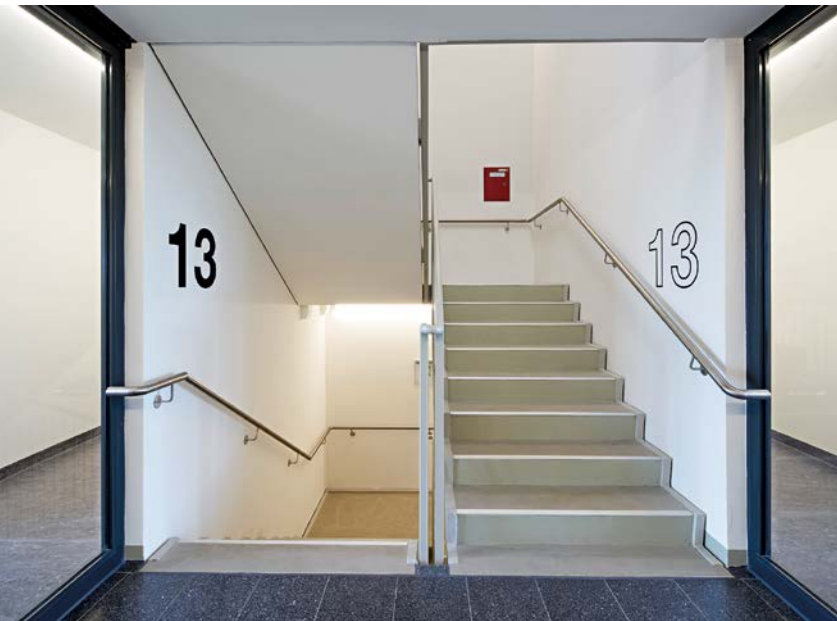
Um den Brandschutzanforderungen zu genügen, wurde ein zweites Treppenhaus in das Wohnhochhaus „S1“ eingebaut
