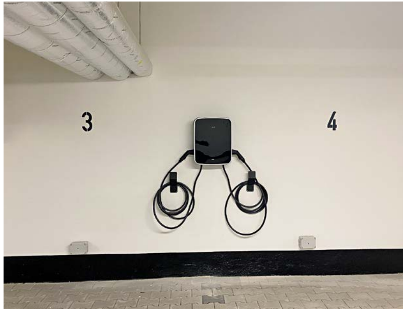
Mieterstrom-Ladestation in der Tiefgarage eines Wohngebäudes
